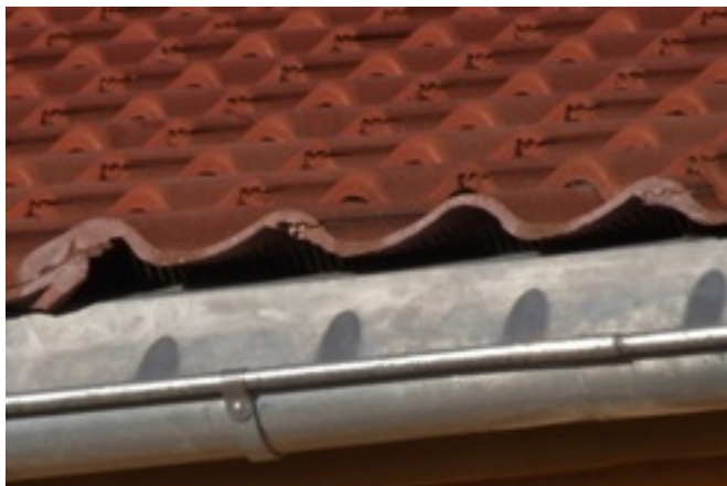
Billede: Dryp fra betontagsten
